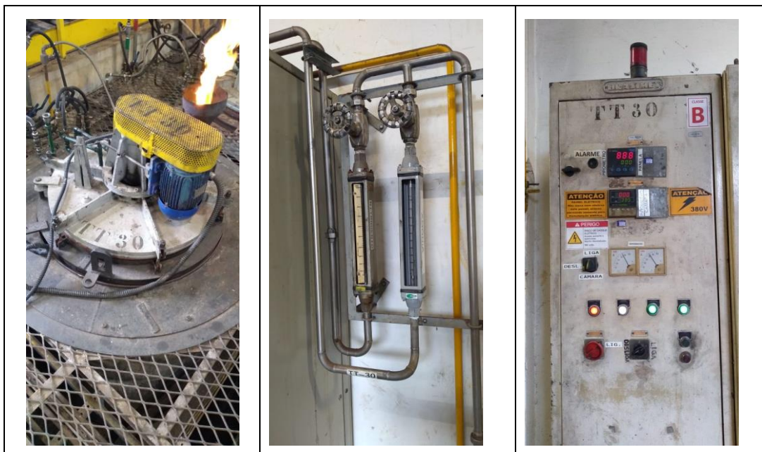
Figura 35: Forno tipo poço usado no processo de nitretação a gás na empresa DELPHI.
