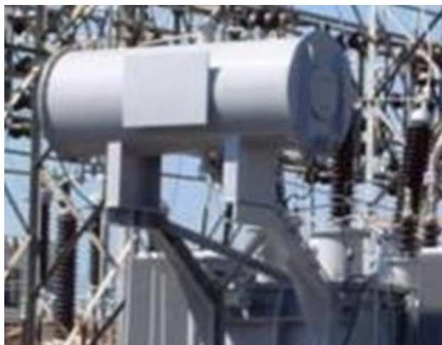
Figura A.2 - Tanque de expansão com tubulações de óleo
