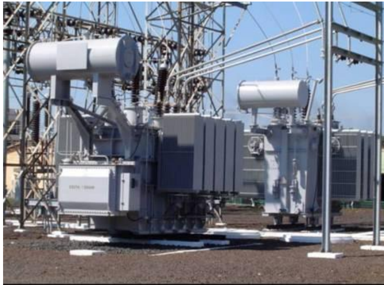
Figura 2.1 - Foto da Subestação da CPFL - Transformadores em paralelo
