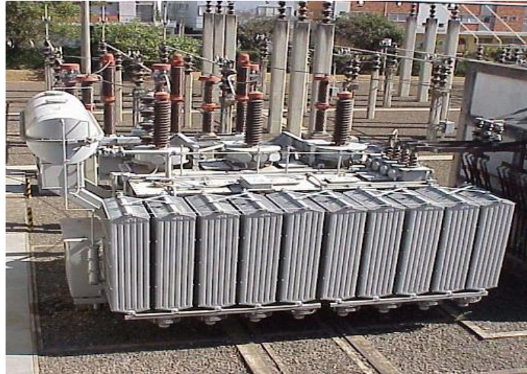
Figura 2.2 - Transformador de potência 138/13,8kV, 50MVA
