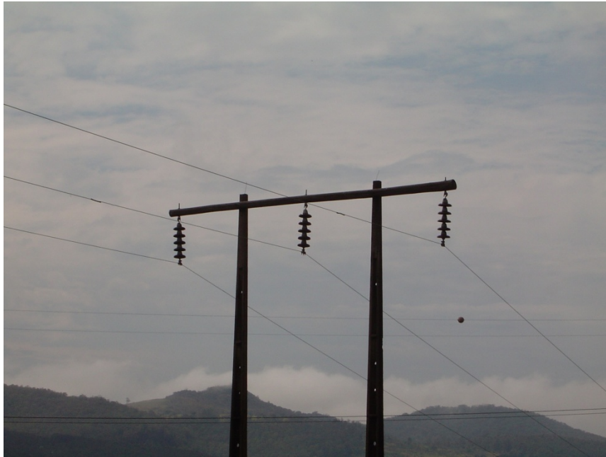
Figura 3.11 – Estrutura do Tipo "HS"
