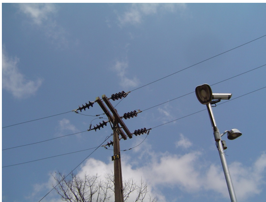
Figura 3.7 – Estrutura do Tipo "G"
