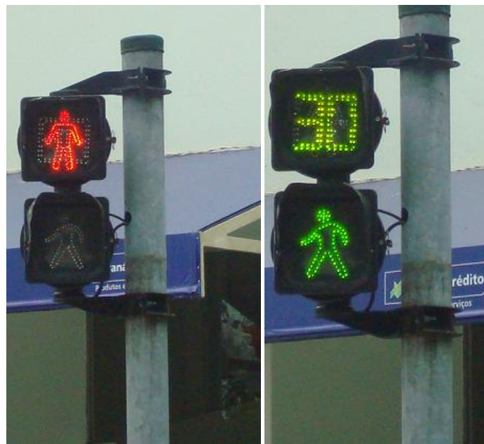
Figura 2. 3- Semáforo de fase para pedestres com informador de tempo – Florianópolis – Brasil.
