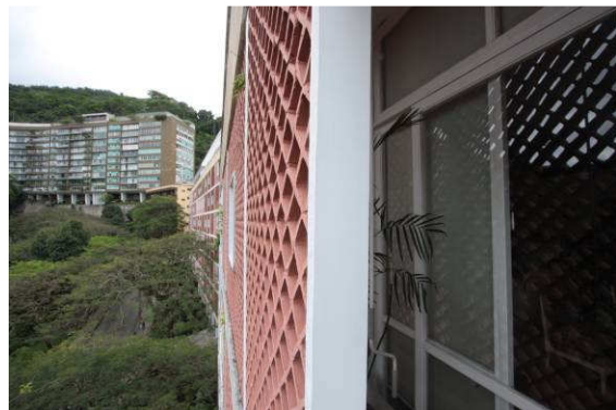
Figura 32. Vista da janela de caixilho ausente no combogó da loggia .
