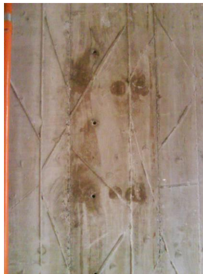
Figura 42. Idem. Nota-se as marcas dos nós das tábuas de forma.
