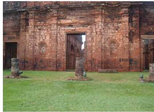
Figura 16 Fachada da Igreja sem visão do pórtico . Note-se o porticado da nave lateral esquerda em desaprumo.
