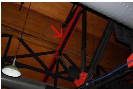
Figura 17. Tesoura do Teatro SESC Pompéia: a seta indica a intervenção de Lina, pintadas de vermelho, nas barras comprimidas; o reforço dos nós, também vermelhos, é recente.
