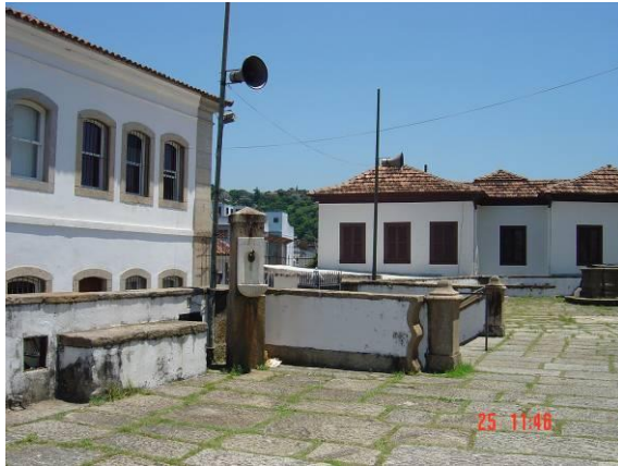
Figura 3. Encontro do guarda-corpo com o corrimão no adro da Igreja de Nossa Senhora do Outeiro da Glória.
