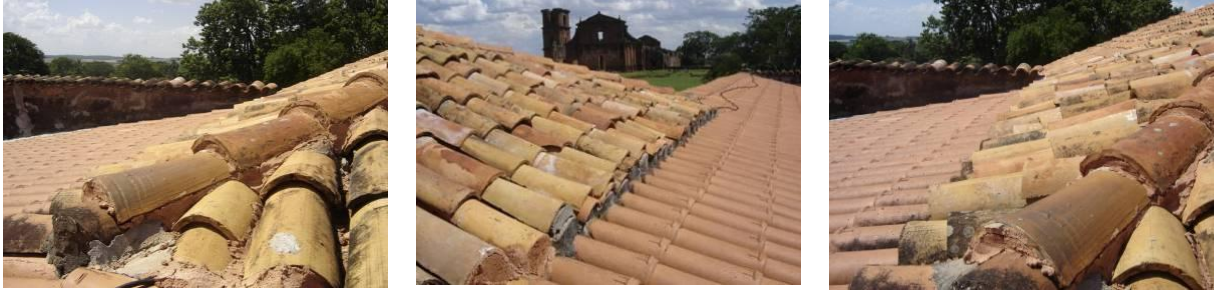
Figura 41. Várias imagens da junção do muro de pedras com telhado do alpendre do museu e das junções do telhado do museu com o telhado da casa do zelador. Vê-se que o telhado da casa foi refeito recentemente. Mas o detalhe é de uma água contínua da tacaniça de uma das faces do museu.
