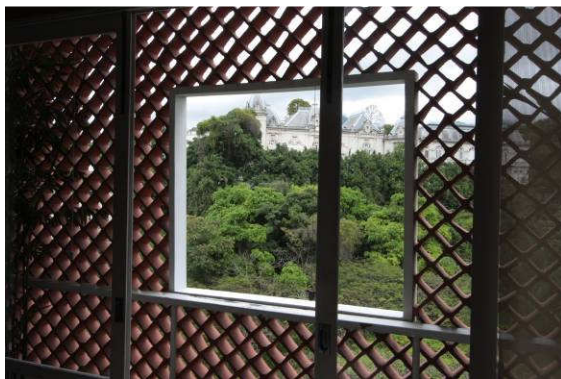
Figura 60. Janela do caixilho ausente , com vista para o Palacete.
