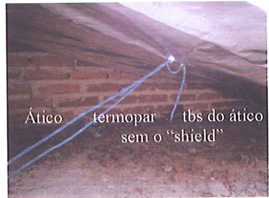
Figura 22 – colocação do foil – vista de dentro do ático, onde se pode visualizar que o foil apresenta uma pequena ondulação depois de instalado. Percebe-se também a presença do sensor de bulbo seco do ático antes da colocação do “shield”.
