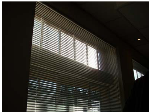
Fig. 53 – Exemplo de protetor solar interno, auditório do Campus de Ciências Agrárias – UFPR em Curitiba- PR.
