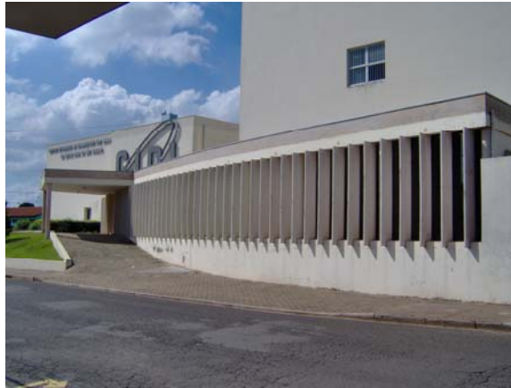
Fig. 56 – Protetores solares fixos, Centro Integrado de Diagnóstico por Imagem da Santa Casa de São Carlos-SP.
