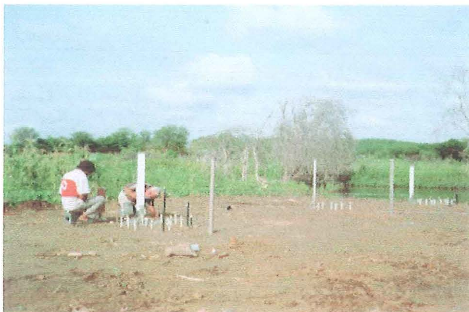
FIGURA 14 – Vista geral da instrumentação instalada no Açude Cajueiro
