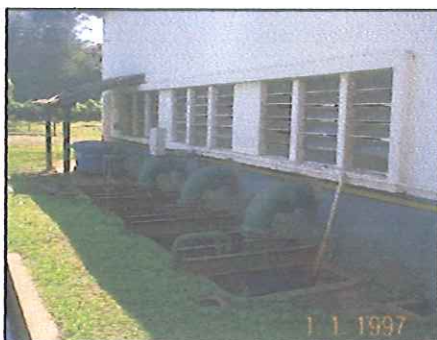
Foto 48 Localização: Área Rural/Urba Coordenadas: 203140.86 / 7565897.68 Descrição: Casa de bomba da captação do Espraído
