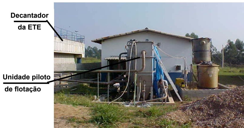
FIGURA 4.7 – Vista do sistema piloto de flotação por ar dissolvido, montado próximo aos decantadores secundários da ETE - Jardim da Flores.
