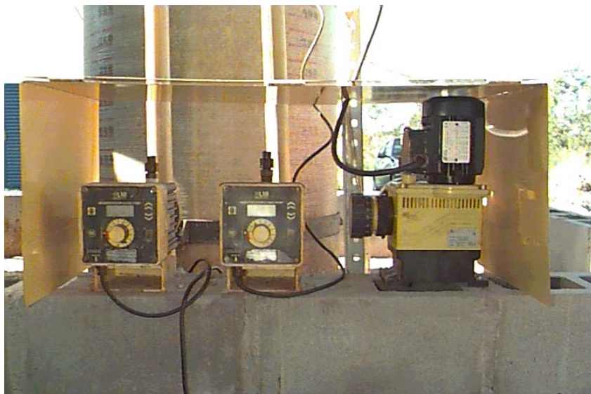
FIGURA 4.11 – Bombas dosadoras de soluções de substâncias coagulantes e floculantes.
