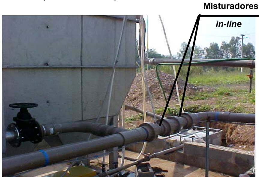
FIGURA 4.10 – Misturadores de substâncias coagulantes e floculantes na tubulação do afluente à flotação.
