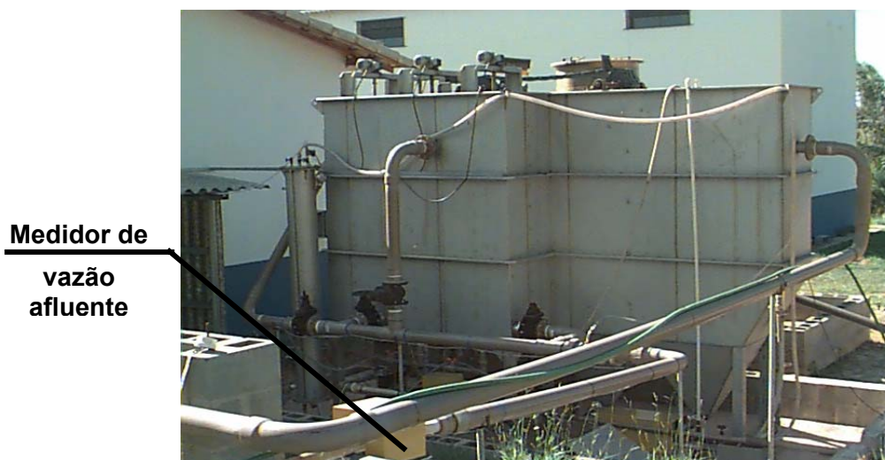
FIGURA 4.8 – Vista da unidade FADAT e do medidor de vazão instalado na tubulação afluente ao flotador.
