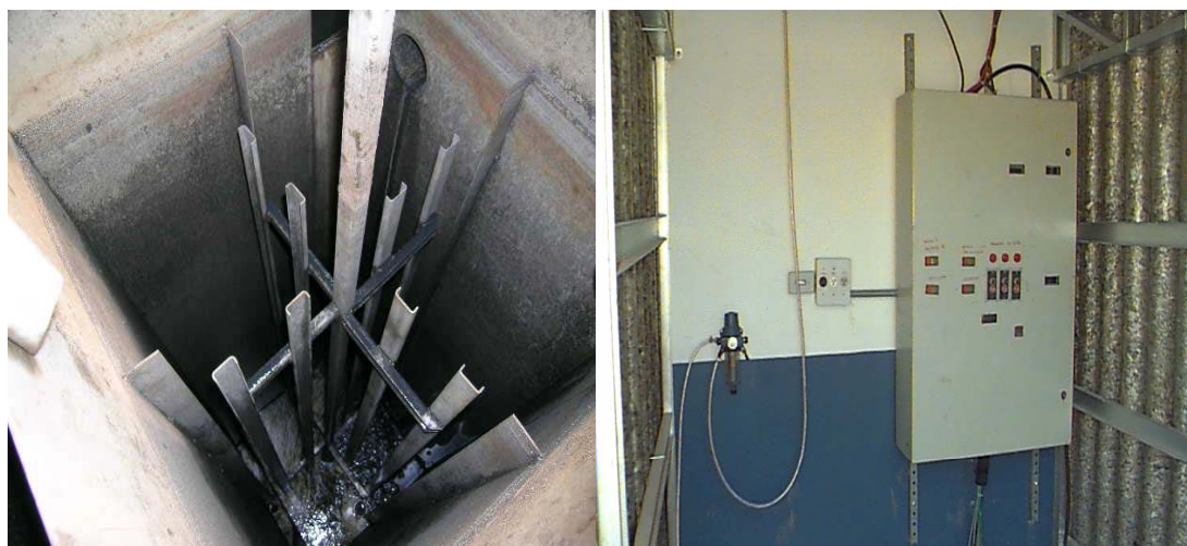
FIGURA 4.13 – Detalhes da câmara de floculação, com respectivo agitador lento mecanizado, e do quadro elétrico.
