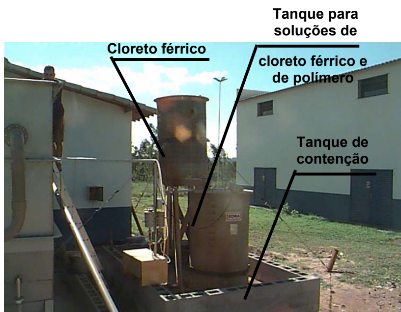
FIGURA 4.9 – Tanques para armazenamento de cloreto férrico e de soluções de cloreto férrico e polímero.
