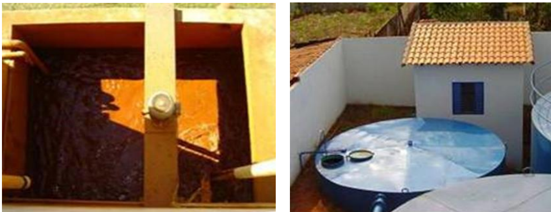
Figura 3.10 – Tanque de regularização de vazão Fonte: SABOGAL PAZ (2007).
