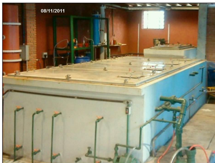
Figura 13 - Reator anaeróbio compartimentado. Foto da autora.
