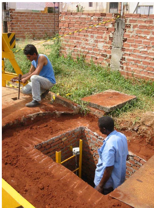
Figura 4.10 – acionamento de descarga de rede (D96 – Alvorada)
