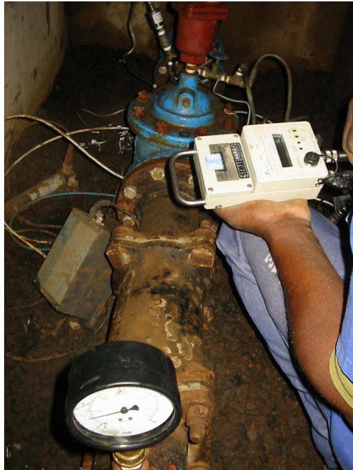
Figura 4.2 – aspecto da caixa de proteção da VRP na entrada do setor
