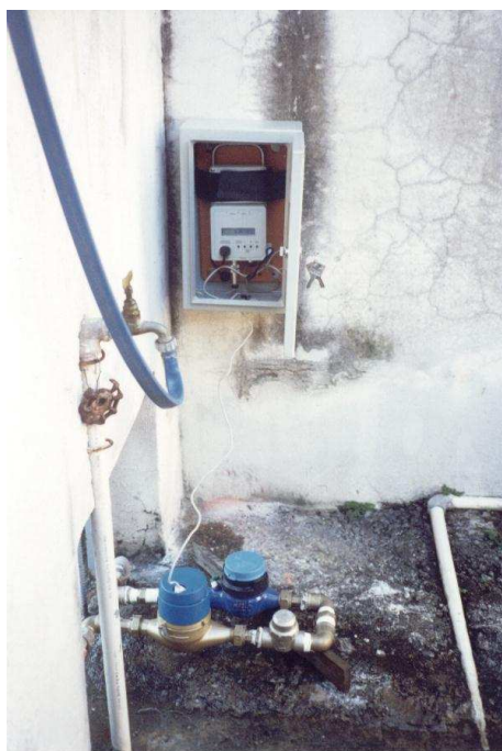
Figura 5.10 – instalação típica de medidor com coletor de dados
