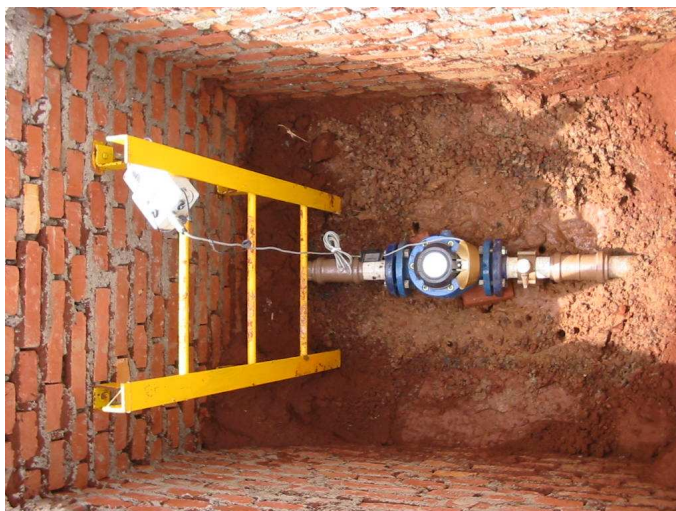
Figura 4.5 – descarga D96 (Alvorada) com medidor e coletor de dados
