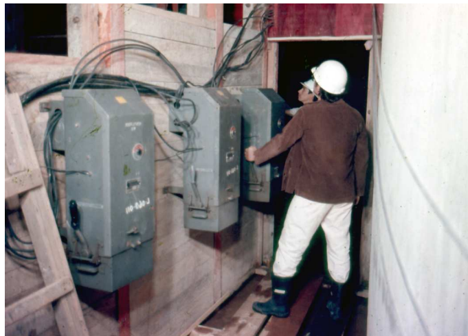
Figura 4.8: Central de acionamento dos ventiladores
