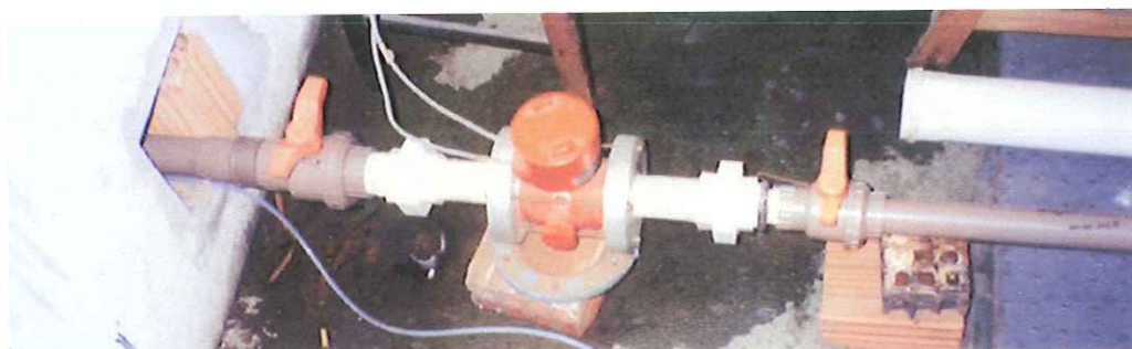
Foto 3 – Medidor de vazão eletromagnético CONAUT
