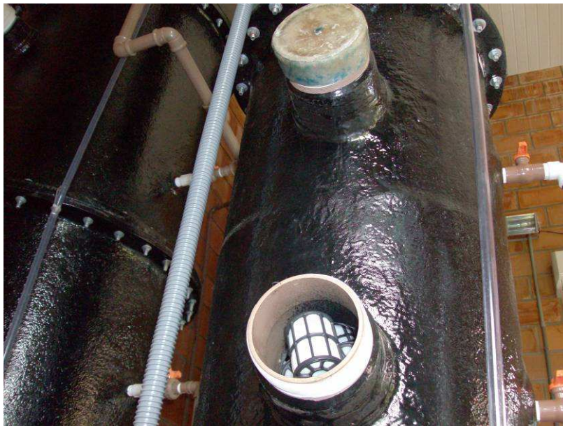
Figura 4.13 – Poços de inspeção para coleta do material suporte nos compartimentos.
