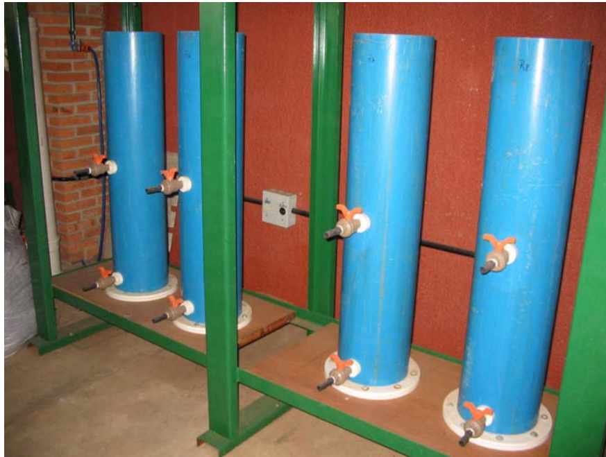
Figura 6 - Filtros percoladores utilizados para o pós-tratamento de efluente de reator anaeróbio compartimentado
