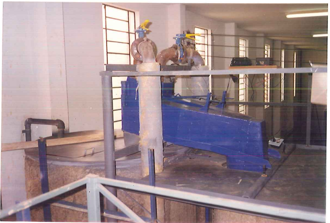
Foto 2 : Desviador de Escoamento.
