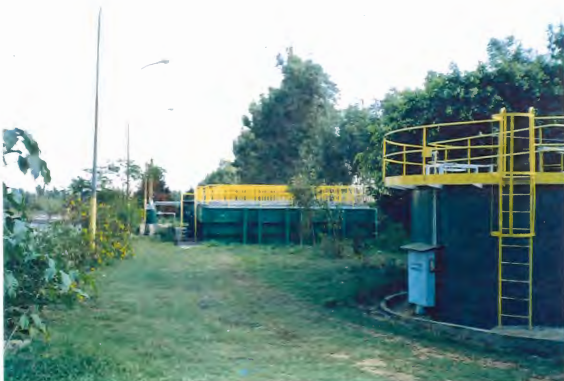
Figura 3 - Vista dos biodigestores
