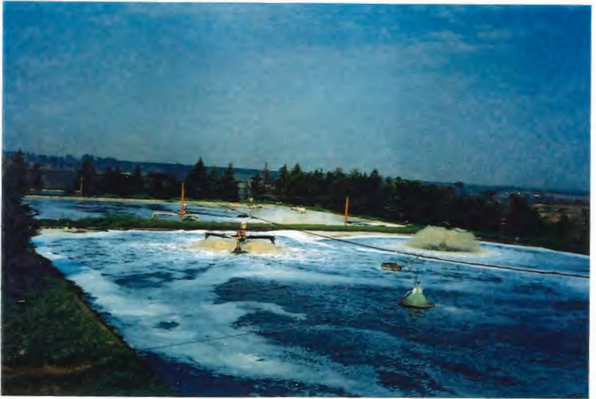
Figura 5 - Vista das lagoas aeradas
