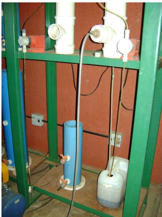
Figura 29 – Sistema de recirculação empregado nas torres de arraste
