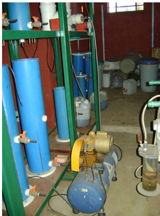
Figura 30 – Compressor de ar ligado à torre
