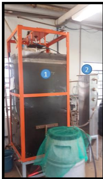
Figura 5 - Sistema de Lodo Ativado - (1) Tanque de Aeração; (2) Decantador Secundário
