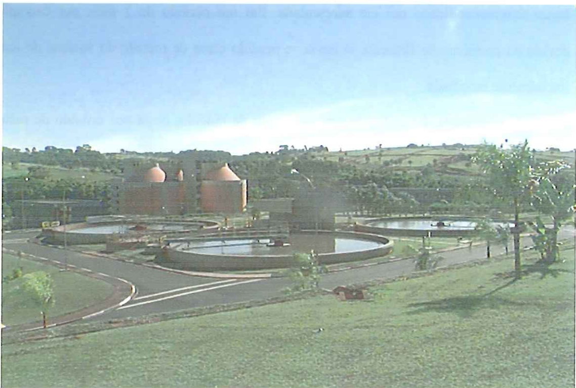
Figura 4.4. Decantadores primário da ETE Franca com digestores de lodo ao fundo
