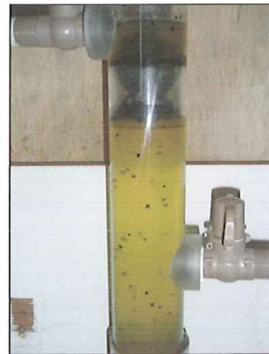
Figura 5.26 - Lodo flotado no Reator 4
