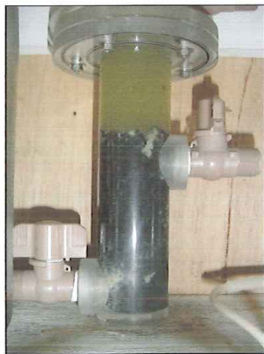
Figura 5.21 - Lodo da base do Reator 2
