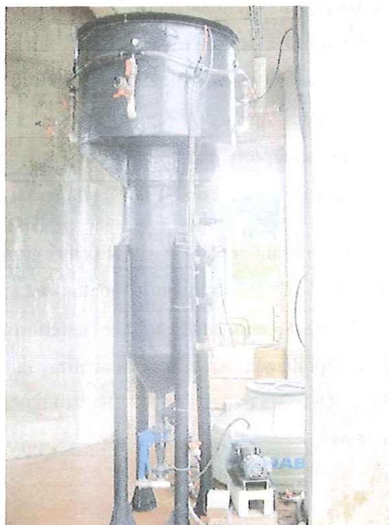
Figura 4-4: Foto do sistema de tratamento.
