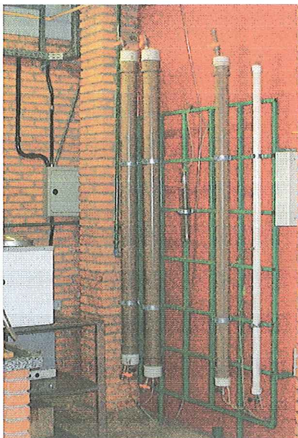
Fotografia 4 – Coluna de PVC para aplicação de ozônio.
