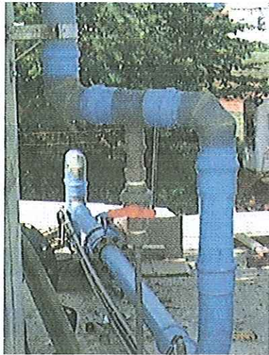
Fotografia 15 – Tubulação para coleta do efluente do reator anaeróbio de leito expandido.
