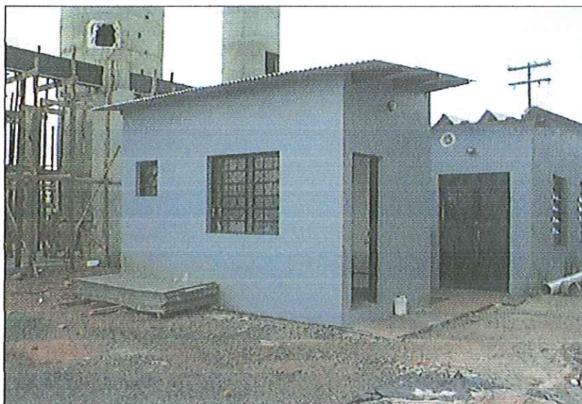
Fotografia 7 – Abrigo da unidade de ozonização e biofiltro aerado submerso
