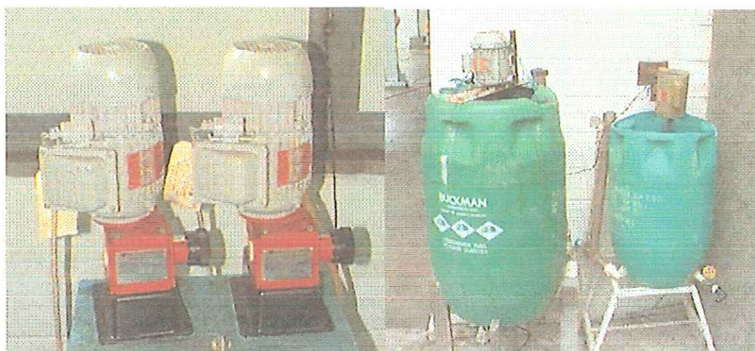
FIGURA 25 -Fotografia das bombas dosadoras para solução do coagulante e alcalinizante e dos reservatórios para a preparação das soluções
