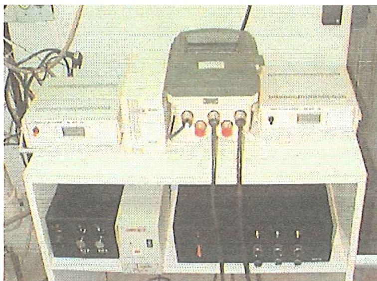
FIGURA 24- Fotografia do conversor eletromagnético da vazão de recirculação e dos medidores eletrônicos de vazão
