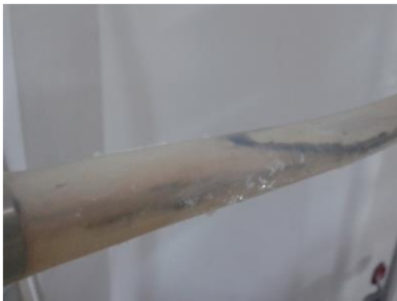
Figura 5-347 - Indícios de produção de H_2S nas mangueiras de recirculação.
