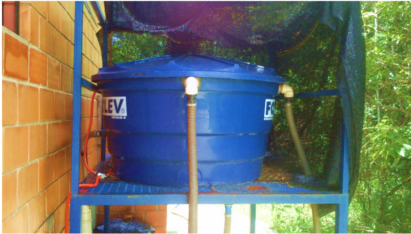
Figura 4.5 - Reservatório para armazenamento de esgoto.
