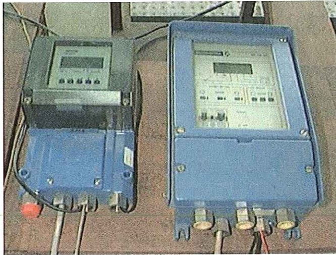
Figura 22 – Vista dos medidores de vazão
