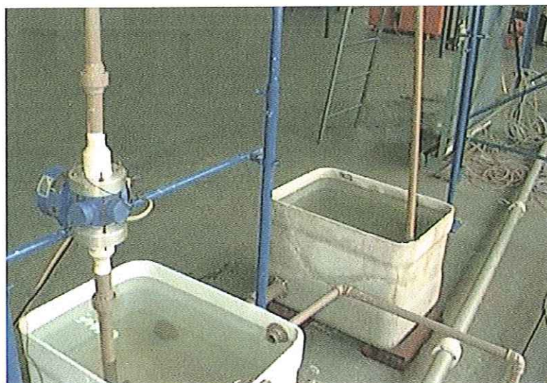
Figura 35 – Vista das caixas d'água
