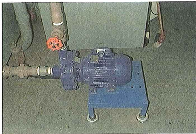
Figura 19 – Vista da bomba
