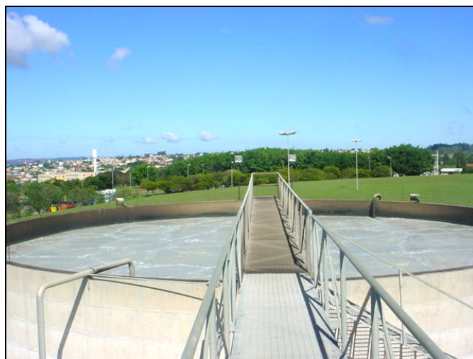
Figura 4.3 - Tanque de homogeneização aerado de 1000m 3 da E.T.E.
