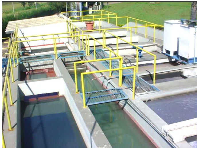
Figura 4.4 - Tanques de coagulação, floculação e sedimentação da E.T.E.
