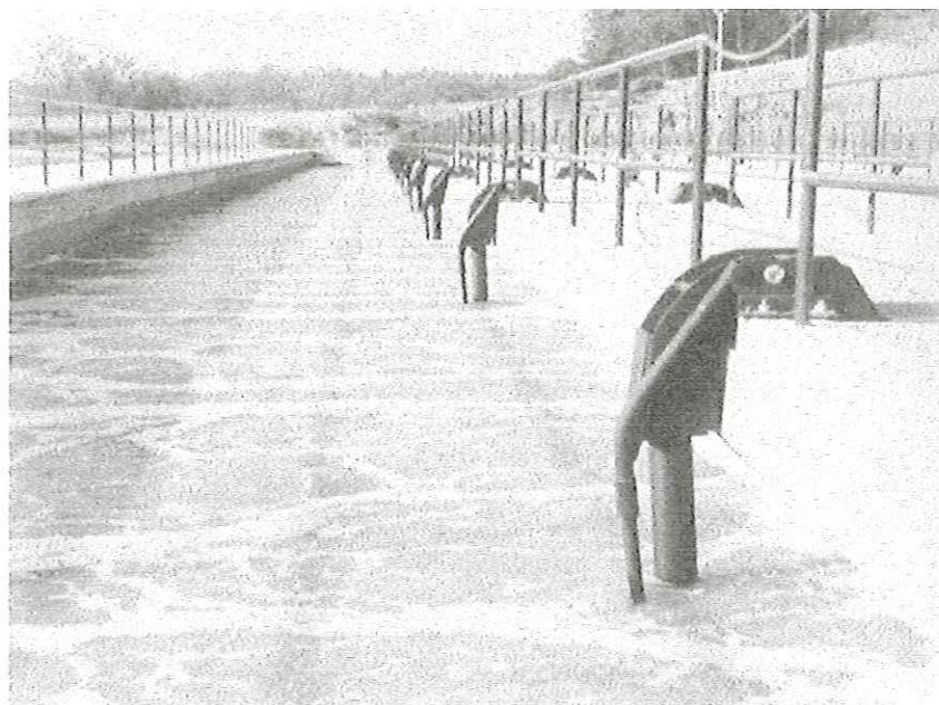
Figura 2.13 – Vista de um longo tanque de aeração com sistema de aeração múltipla instalado e em operação. Fonte: GIBBON (1974).
