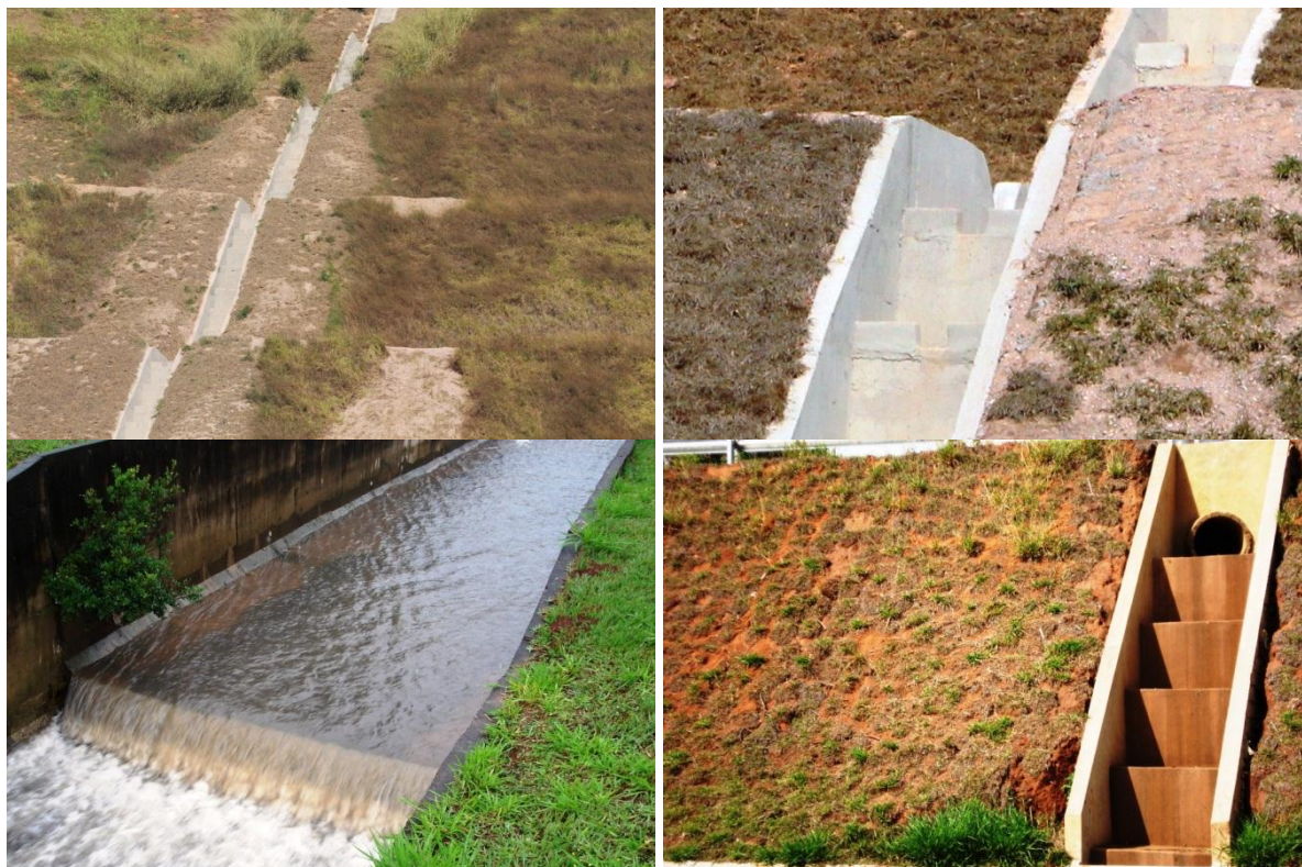
Figura A1.31 – Canais em degraus utilizados em sistemas de drenagem em rodovias (seis primeiras imagens: Rodovia Bandeirantes-SP; penúltima: Córrego Tijuco Preto, São Carlos-SP; última: canal do sistema de drenagem próximo à entrada de São Carlos-SP).
