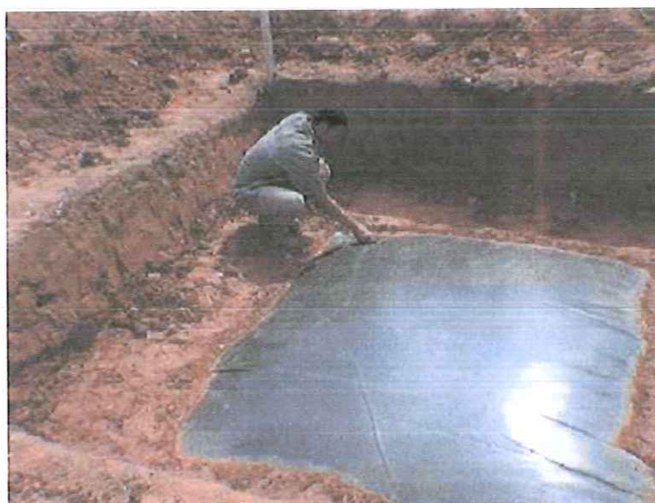
Figura 3.6. Geomembrana de HDPE, estufada devido à presença de gás.
