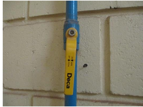
b. Válvula de liberação do ar comprimido na rede de distribuição do laboratório
