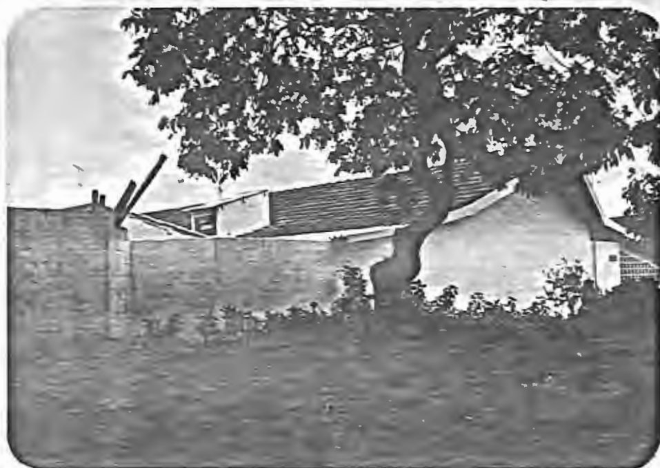
FIG. 29 - VISTA MOSTRANDO A SOLUÇÃO ADOTADA PARA ILUMINAÇÃO E VENTILAÇÃO DE BANHEIROS EM ALGUMAS REFORMAS.
