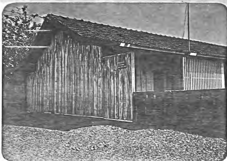
FIG. 46 - PAREDES DETERIORADAS NAS CASAS DE MADEIRA POR FALTA DE UMA MANUTENÇÃO ADEQUADA.
