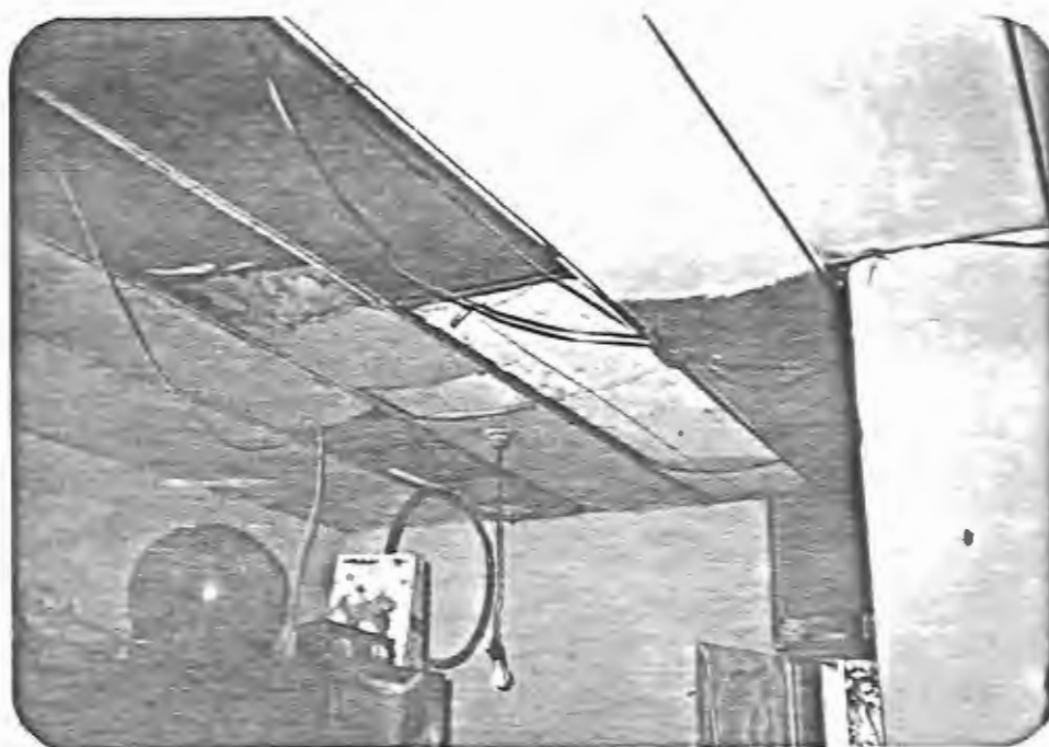
FIG. 49 - VISTAS MOSTRANDO FORROS DETERIORADOS.
