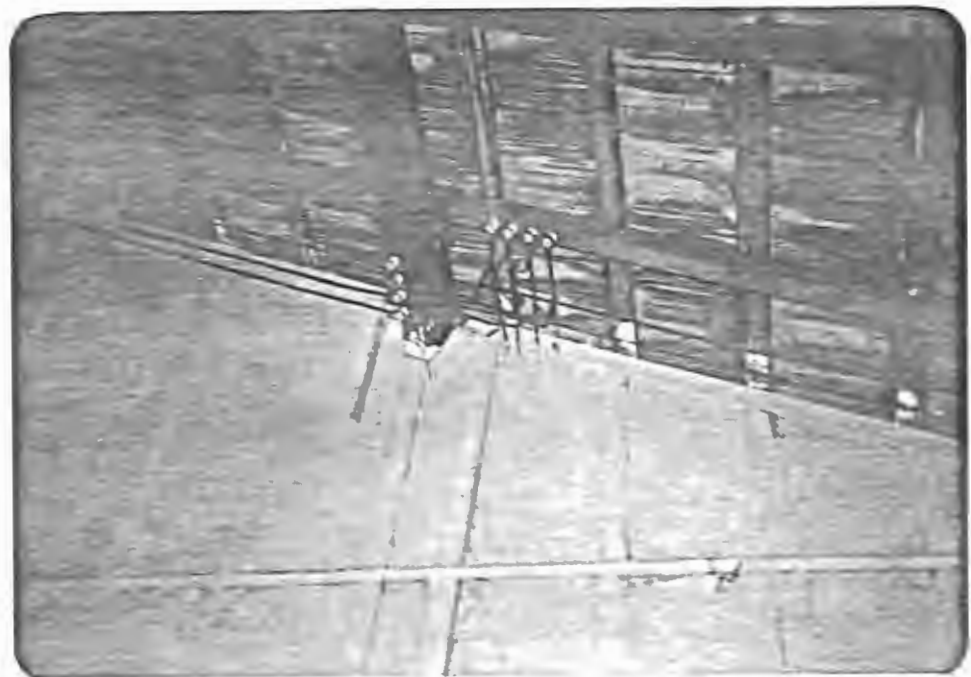
FIG. 53 - DETALHES DAS INSTALAÇÕES ELÉTRICAS NAS CASAS DE MADEIRA.
