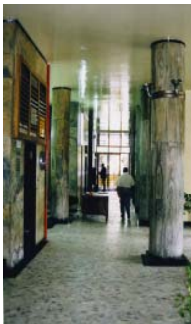
Fig. 253 - Foto de 1998, mostrando as condições do térreo do Edifício Esther. Foto: Fernando Atique, 1998.
