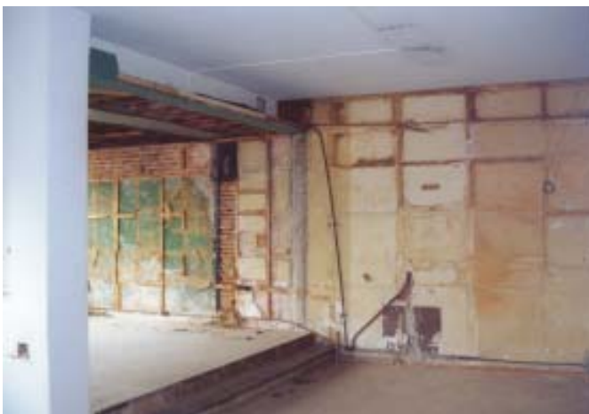
Fig. 243 - Visão da sala principal da unidade 1102, que demonstra seu precário estado de conservação. À esquerda vê-se o volume anexado à área original do apartamento. Foto: F. Atique, 2001.
