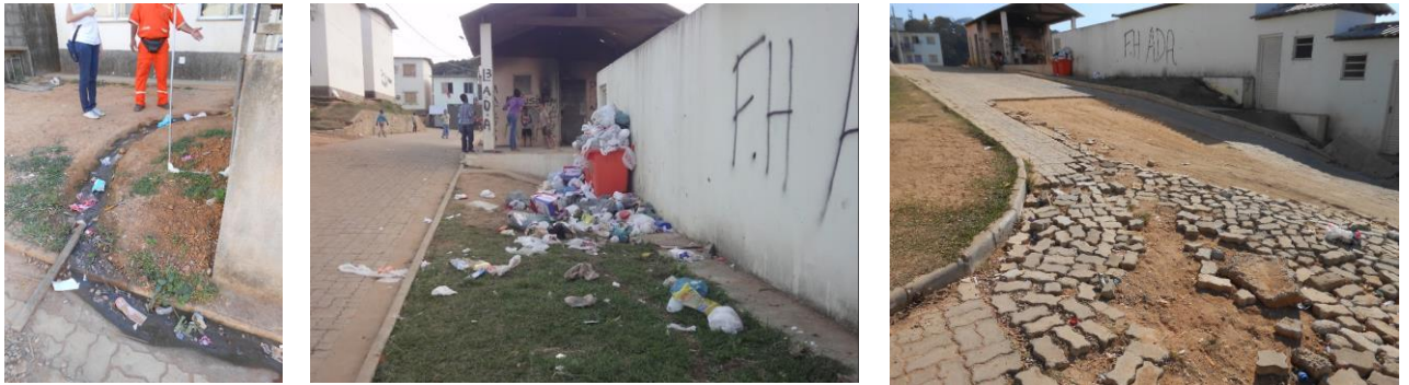
Figura 13 - Fotos retratando alguns dos problemas relatados dentro do CVB (vazamento de esgoto, lixo espalhado e blocos da pavimentação soltando)
