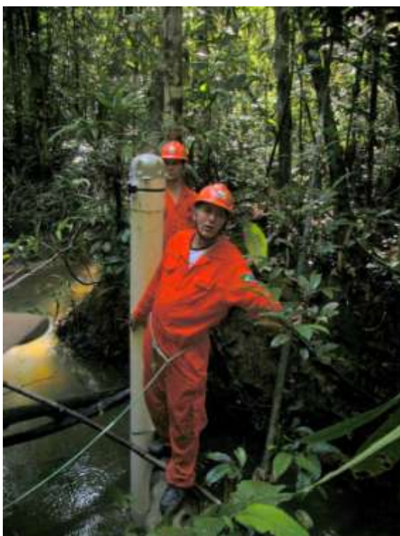
Figura 75 - A imagem mostra a instalação do Robô Kwata Linígrafo, que registra o nível dos rios. O equipamento entrou em operação na última viagem da equipe do Cenpra à Província Petrolífera de Urucu, em março de 2008.
