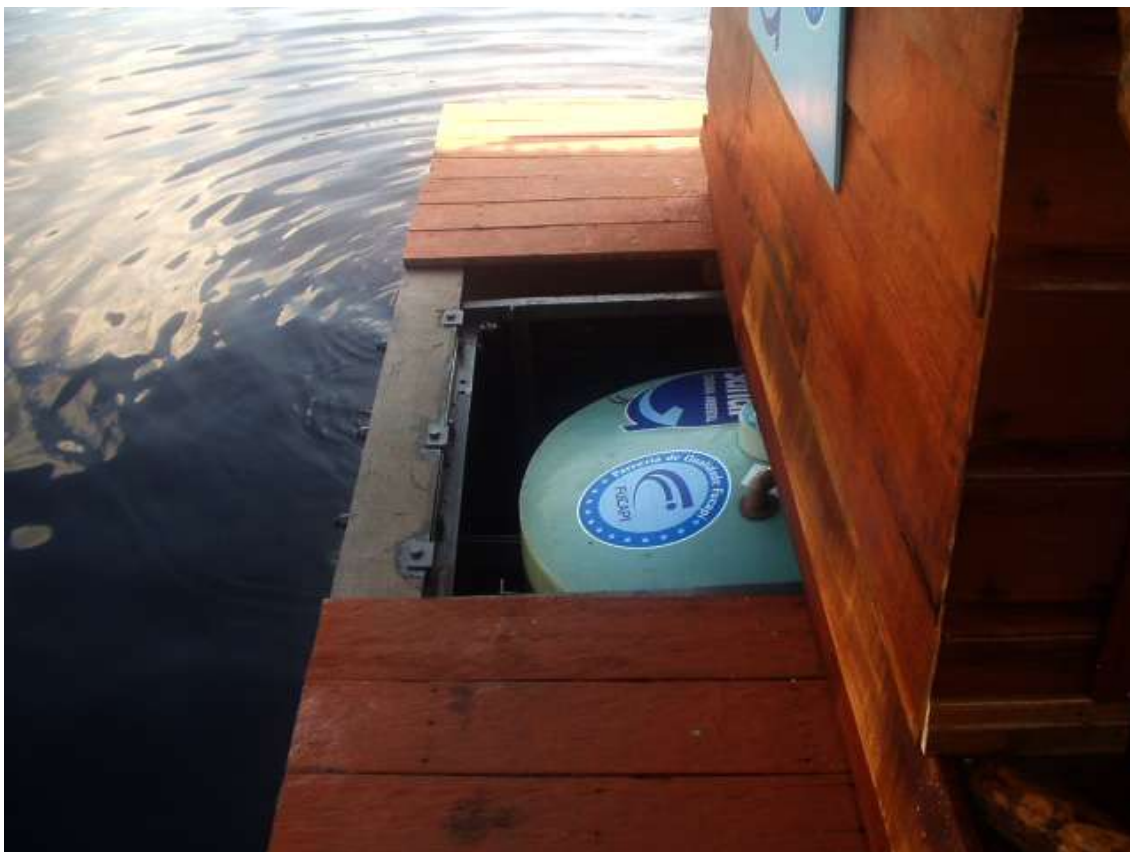
Figura 54 - Sistema de tratamento de efluentes Sanar/FUCAPI instalado no Restaurante flutuante da “Tia” – Rio Tarumã - Manaus
