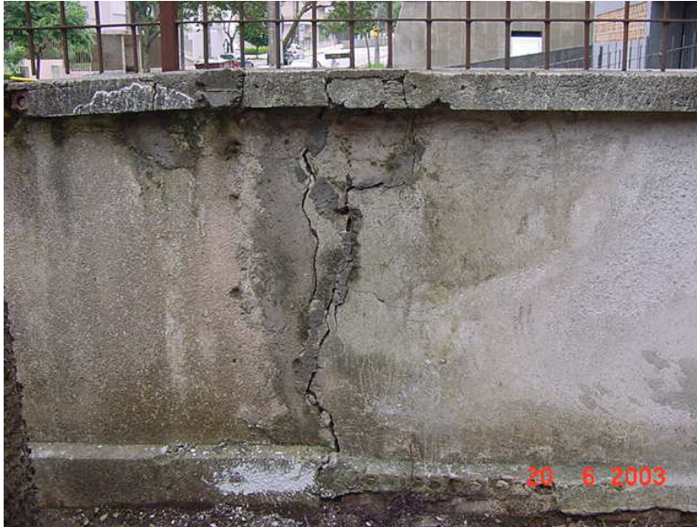
Muro lateral com grande fissura, já profunda atingindo sua fundação
