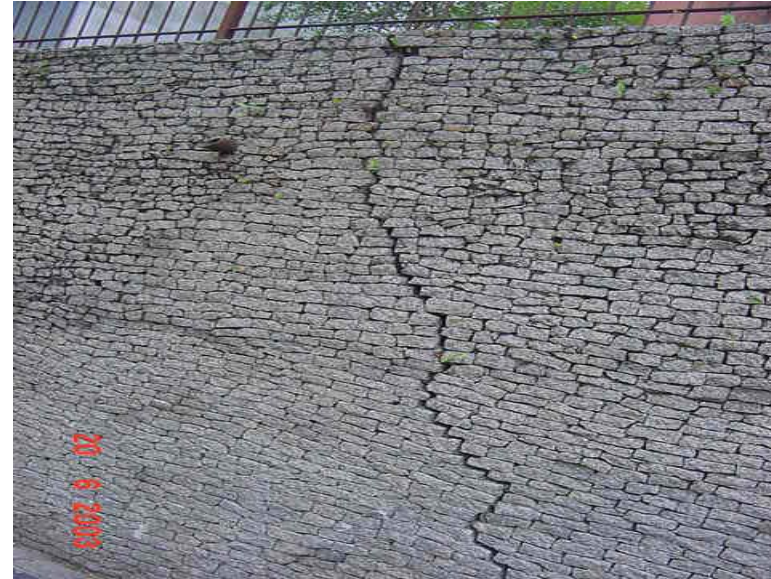
Muro frontal (de arrimo) com fissura passante (do lado interno para o externo, rompendo o revestimento de pedras encaixadas)
