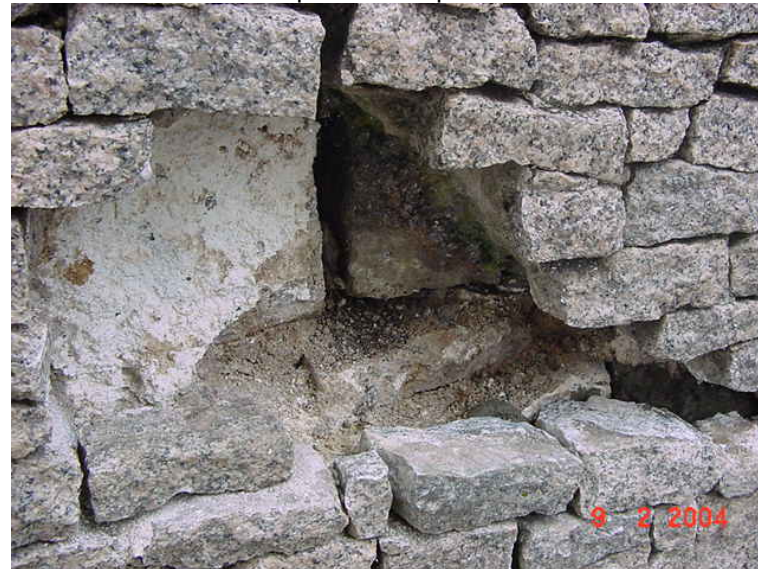
Trinca do muro frontal
