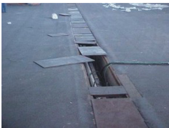
imagem 5-2 As canaletas de serviço
