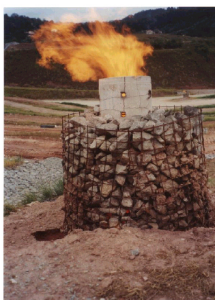
Figura 4.5 – Flare do aterro Bandeirantes – São Paulo – 2004 Fonte: Material informativo sobre o biogás do aterro Bandeirantes
