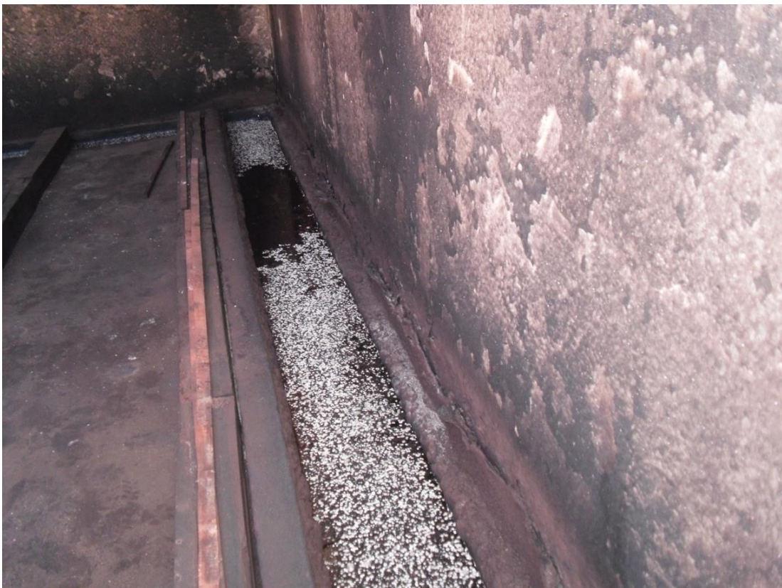
Figura 11 – Resíduo formado no local da câmara onde há a resistência elétrica que aquece a água, armazenado pelo período de uma semana 5 .
