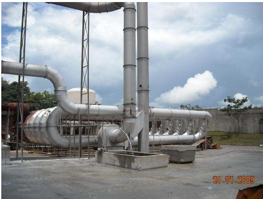
Figura 10A – Sistema de exaustão e captação de óxidos sublimados que formam as cinzas neste processo
