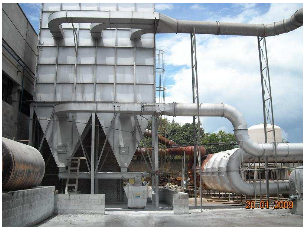
Figura 11A – Sistema de filtros de mangas para deposição e captação das cinzas
